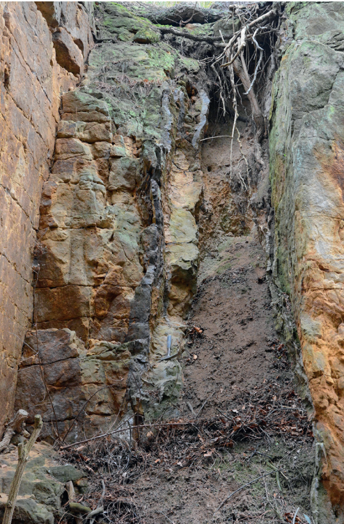
Hlavní žíla vulkanitu v pravé stěně výpustní strouhy Máchova jezera. Hornina je téměř zcela rozložená na jilové minerály a oxihydroxidy železa. Podél obou kontaktů s pískovcem je doprovázena železitými výstelkami. Pohled k SSV. Foto Jiří Adamovič.
