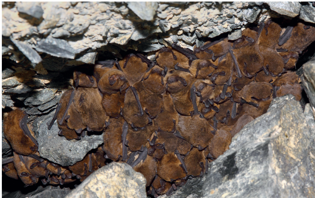
Obr. 4 Část jedinců netopýra hvízdavého zimuje v kapsách a štěrbinách podél spáry na rozhraní skalnatého podloží a betonové výztuže. Foto J. Červený
