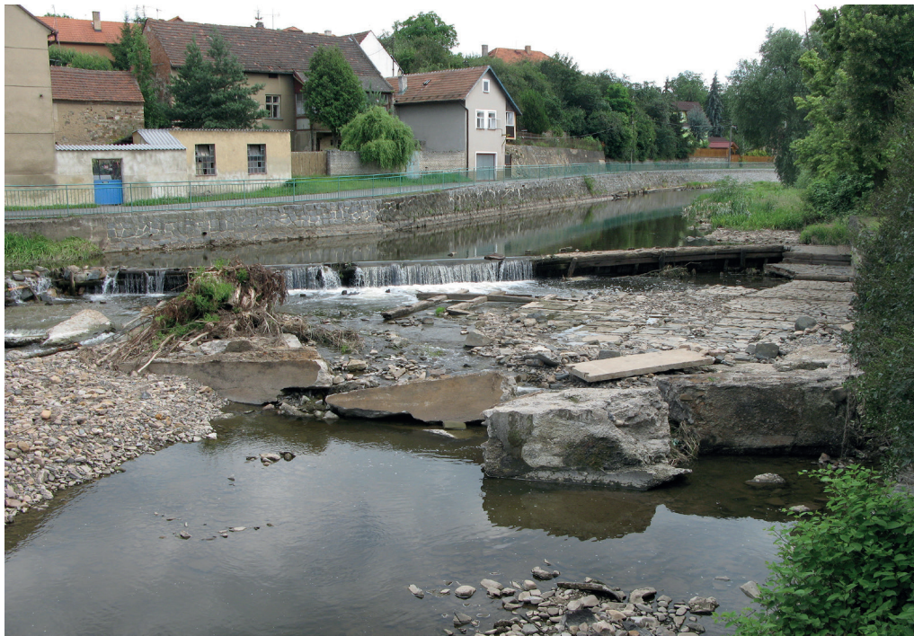
Obrázek 5 Zničený jez v Lochovicích po povodni v květnu 2018, která krátce přemístila i betonové bloky a panely, a odhalila konstrukci původního dřevěného jezu, jenž byl do té doby zanesený sedimentem. Foto Karel Žák
