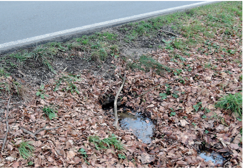
Propustky zanesené bahnem či vodou jsou pro vydry neprůchozí. Náprava je ale velmi jednoduchá a finančně nenáročná (stačí vyčistit). Foto Lukáš Poledník
