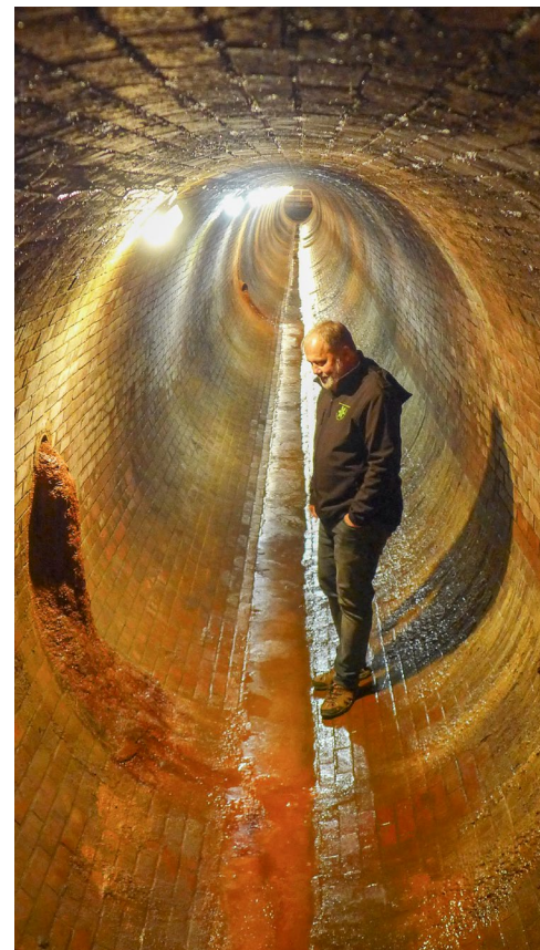
Obr. 6: Jeden z průchozích postranních odtoků usazovacích nádrží. Foto Tomáš Just
