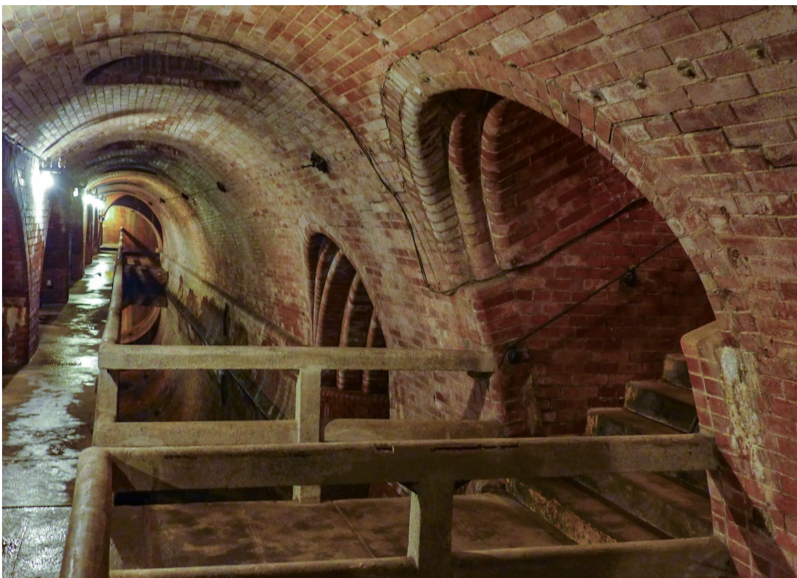
Obr. 1: Přítoková galerie podzemních usazovacích nádrží. Vpravo za přístupovým schodištěm jeden ze dvou přítoků od lapače písku. Vlevo portály usazovacích nádrží. Foto Tomáš Just
