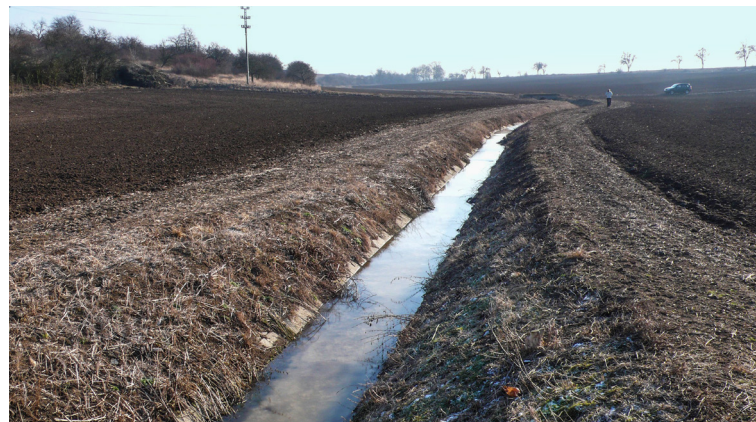
Vodní tok v polích, technickou úpravou proměněný v kapacitní odvodňovací kanál, vyžaduje technické opevnění zajišťující stabilitu koryta. Zrychleně odvádí povodňové i běžné průtoky a svým zahloubením zbytečně odvodňuje přiléhající zeminové vrstvy. Foto Tomáš Just
