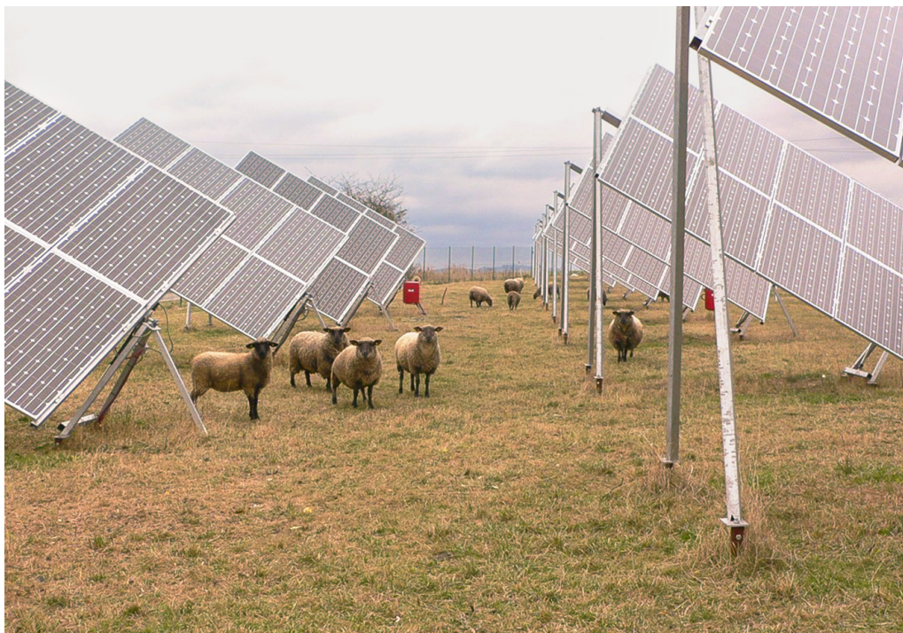
Porůčí nad Sázavou – fotovoltaická elektrárna s pastvou. Foto Jaromír Kosejk
