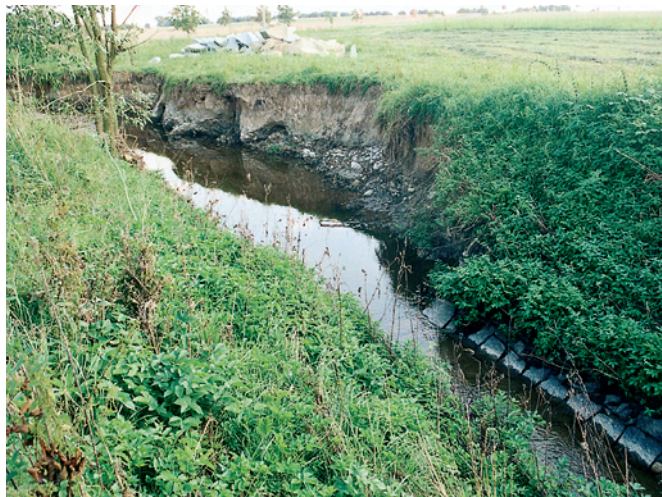
Hvozdánský potok na Rožmitálsku provedl vlnu z protrženého rybníka. V korytě, upraveném do hlubokého lichoběžníkového průřezu, se proudění koncentrovalo do velkých podélných a příčných rychlostí. Tvrdé opevnění kynety bylo destruováno a vznikly velké nátrže
