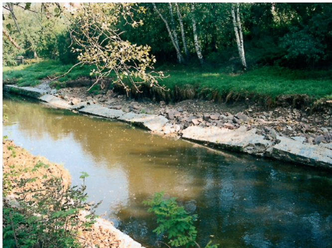
Litavka v Čenkově. Intravilánové opevnění břehovou zdí neodolalo soustředěnému povodňovému proudění. I dle komise správce toku by nemělo být opevnění obnovováno v původní podobě, nýbrž nahrazeno kamenným záhozem. Ten je bližší přírodě, přizpůsobivější zatížením a úspornější
