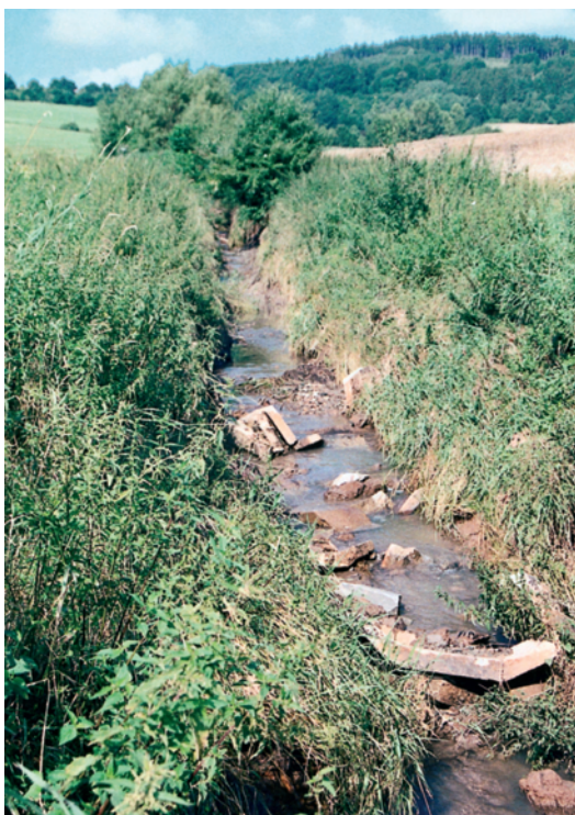
Potok od Kostelních Strámic. Červencová lokální povodeň rozebrala nevhodnou zemědělskou úpravu s hlubokým lichoběžníkovým průřezem koryta a opevněním žlabovkami. Zánik hmotného investičního majetku, evidovaného správcem vodního toku, vytváří příznivou situaci pro revitalizaci potoka
