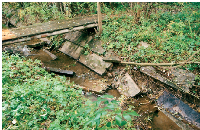
Vůznice nad národní přírodní rezervací. Opevnění potoka plnými betonovými prvky patřilo k „vrcholným číslům“ éry úprav a tzv. meliorací. Povodeň urychlila proměnu nepružného opevnění v to, čemu se někdy říká „fyzikální znečištění koryta“. Situaci je vhodné řešit revitalizací potoka
