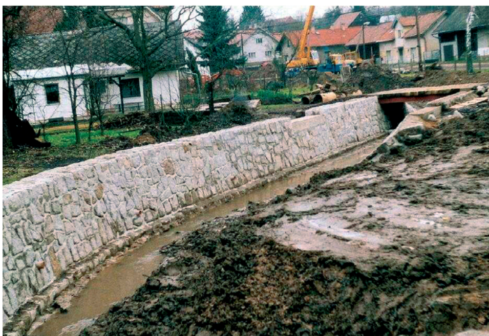
Stísněná zástavba vyžadující nákladné úpravy – tok Lužanka (okres Jičín)
