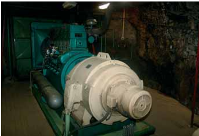
Záložní elektrický zdroj (dieselařegát) podzemního velitelského stanoviště (bunkru)
