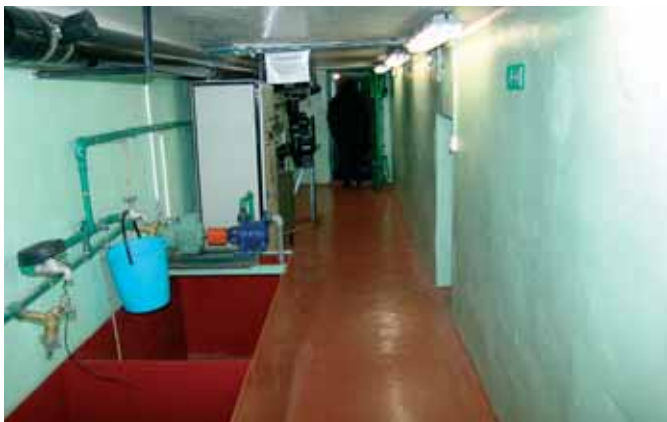
Sanitární propust do podzemního velitelského stanoviště (bunkru) z administrativní budovy
