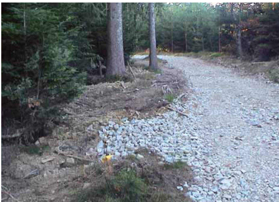
Hřebenový chodník Vsetínských vrchů poškozený nevhodnou úpravou (zpevnění, odvodnění), listopad 2005 Snímky foto Dana Bartošová
