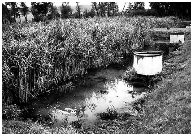
Zaplavení povrchu odpadní vodou bývá příznakem ucpání nebo přicpání vegetačního pole
