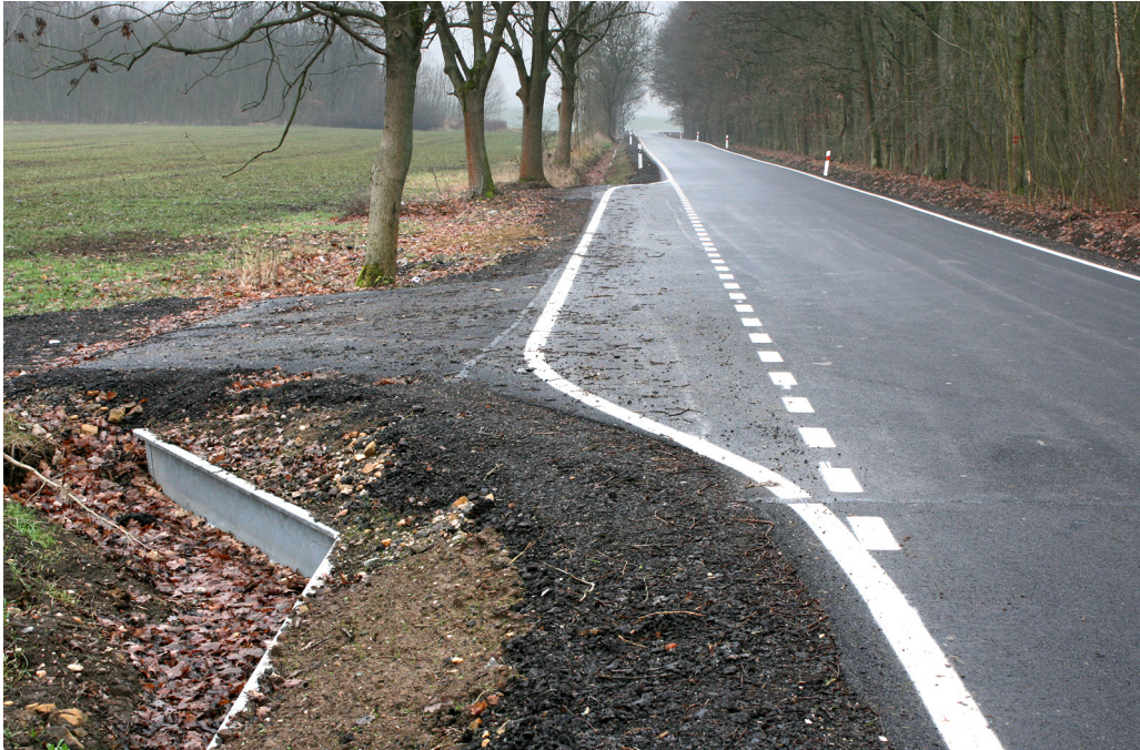
Nově vybudovaná bariéra u Vysokého Veselí je příkladem špatného a nefunkčního řešení. Bariéra není zakončena smyčkou a dlouhý úsek není zajištěn vůbec. Foto Antonín Krása
