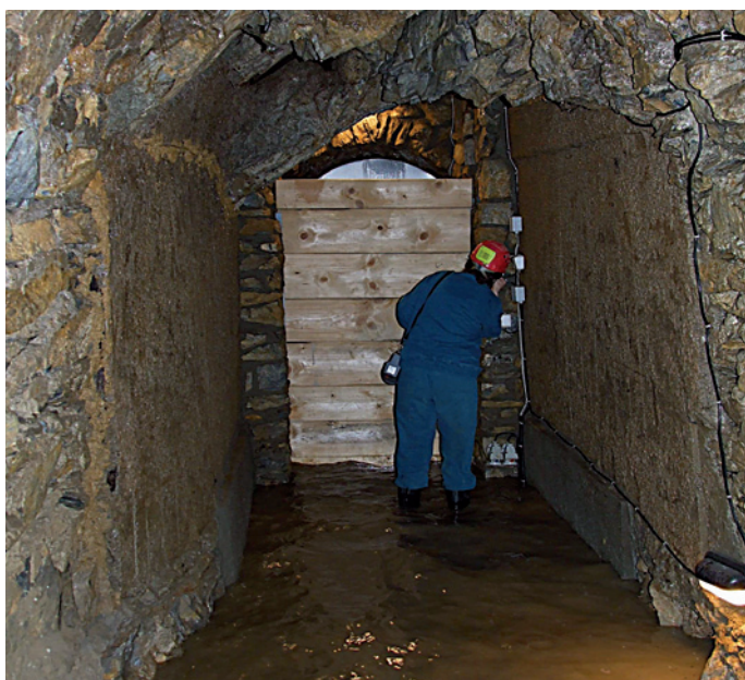
Pohled z výstupní štoly na zajištěná východová vrata, pod nimiž prosákla přívalová voda z Bečvy, 17. května 2010.
