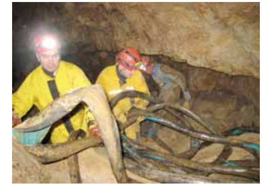
Jednou z nejčastějších prací bylo odstraňování pozůstatků původních zpřístupňovacích a průzkumných prací, různých deponií a zakládek či odpadu ponechaných v minulosti v podzemí (Jeskyně Pod Sněžníkem, 2010). Foto: Vratislav Ouhrabka.
