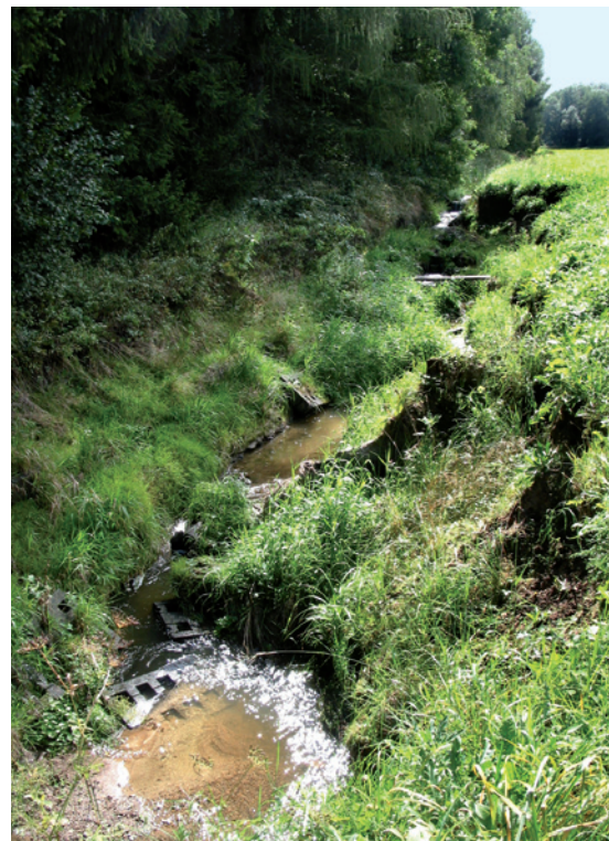
V tomto potoce se úspěšně rozpadlo technické opevnění. Celkově však je koryto, postižené nejdříve technickou úpravou a potom silným vymíláním, příliš hluboké. Bude potřebná revitalizace, která se zaměří na změlčení a hloubkovou stabilizaci koryta.
