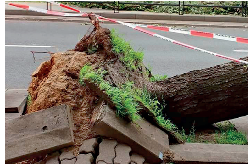
Vyvrácení stromu v důsledku výkopových aktivit kolem kmene. Foto Jaroslav Kolařík
