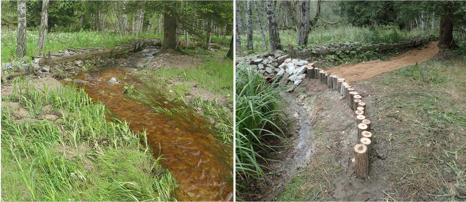
Obr. 5 Protierozní opatření v povodí Zlatého potoka. Za normálního vodního stavu je přepážka na toku průtočná, v případě zvýšení ale protéká jen část určená kapacitou trubky. Nadbytečný průtok se vzedme a vybřeží určeným směrem. Zde protéká přes sérii obloukovitých drobných hrázek, dochází ke zpomalení rychlosti proudění a tím unášecí a erozivní síly proudu. Písek se pak ukládá na rozlivových plochách. Foto Bohumil Dort
