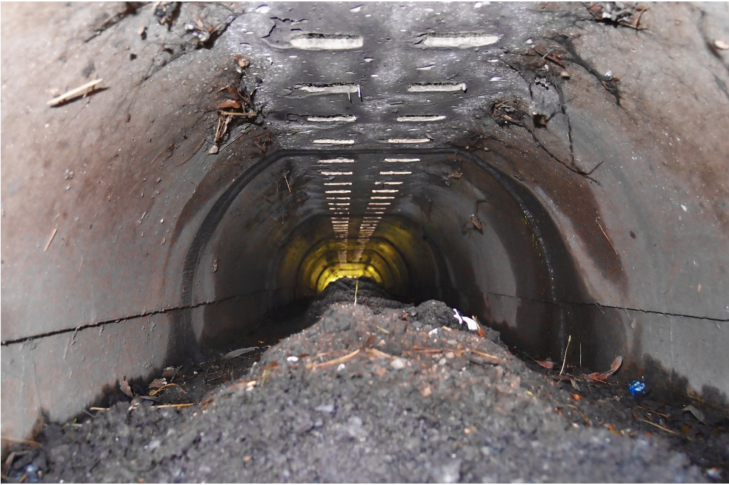
Obr. 3 Zanesený podchod s nedostatečnou cirkulací vzduchu v Těrlicku. Hodnota měřená teploty v prostoru podchodu byla téměř o 5 °C nižší než teplota venkovní. Foto Petr Vlček
