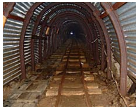
Některé úseky důlních chodeb jsou zajištěny ocelovou výztuží a nově rekonstruovaným pažením.
