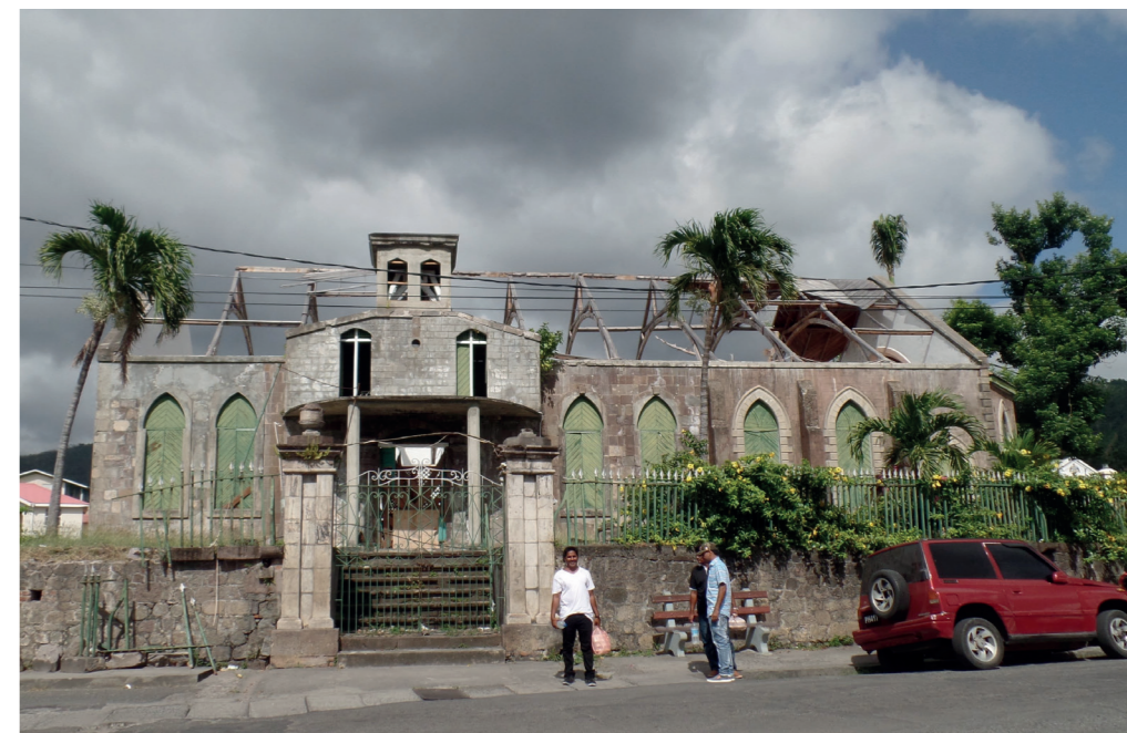
V hlavním městě Roseau stojí hned vedle hurikánem poničeného kostela opravený a nově natřený prezidentský palác. Foto Lucie Záhorová
