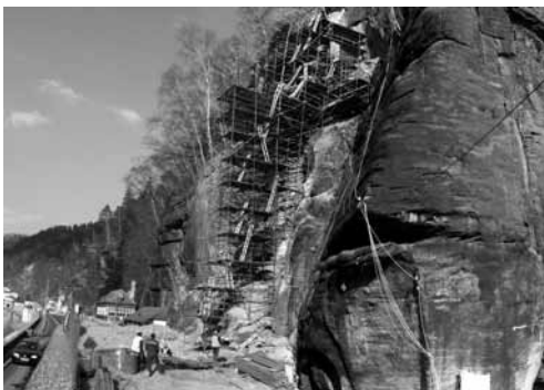
Havarijní odlehčení na Lomové stěně ve Hřensku. Trubkové lešení mělo přes 40 metrů.
