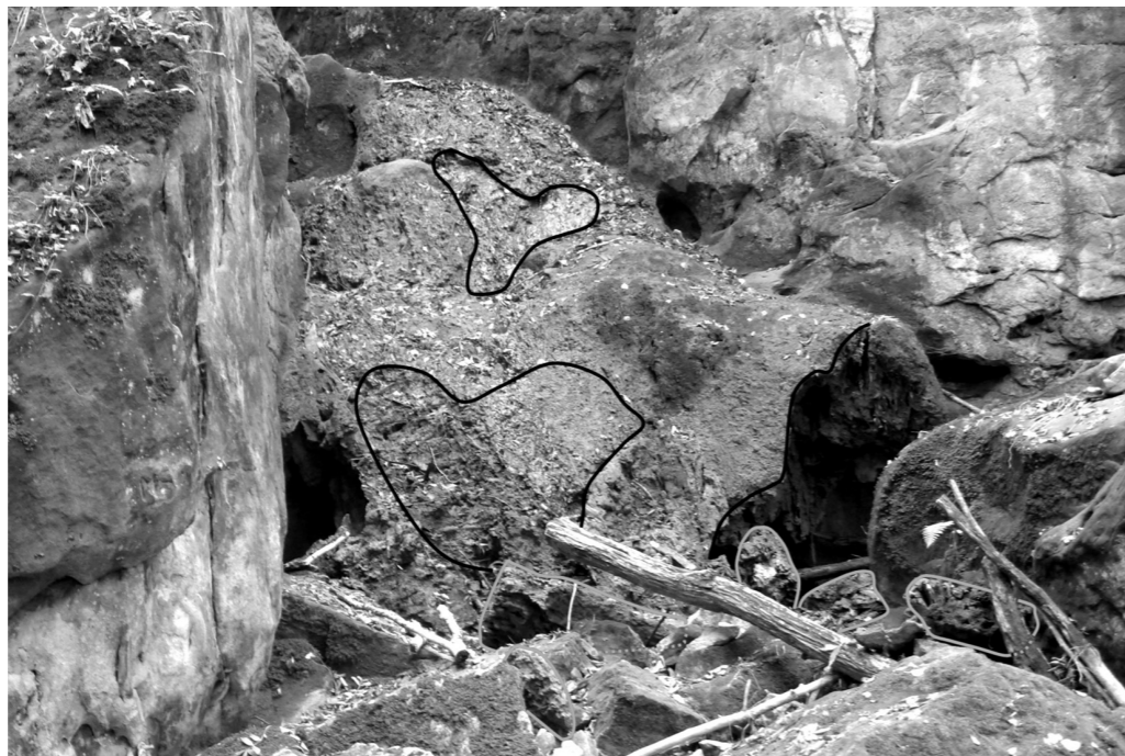
Stav Tachovského vodopádu po povodni. Černě označené jsou plochy a linie, kde došlo k eroznímu odlámání největších kusů pěnovce, dole volné úlomky pěnovce (tečkované skryté části). Dobře patrné je téměř celoplošné erozní obroušení skoro celé vodopádové stěny, zbavené vegetace. Foto Vlastimil Pilous
