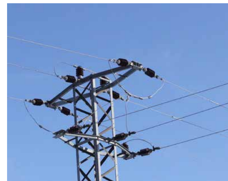
Odbočovací nebo rohové příhradové sloupy patří k nejnebezpečnějším konstrukcím. Foto Václav Hlaváč
