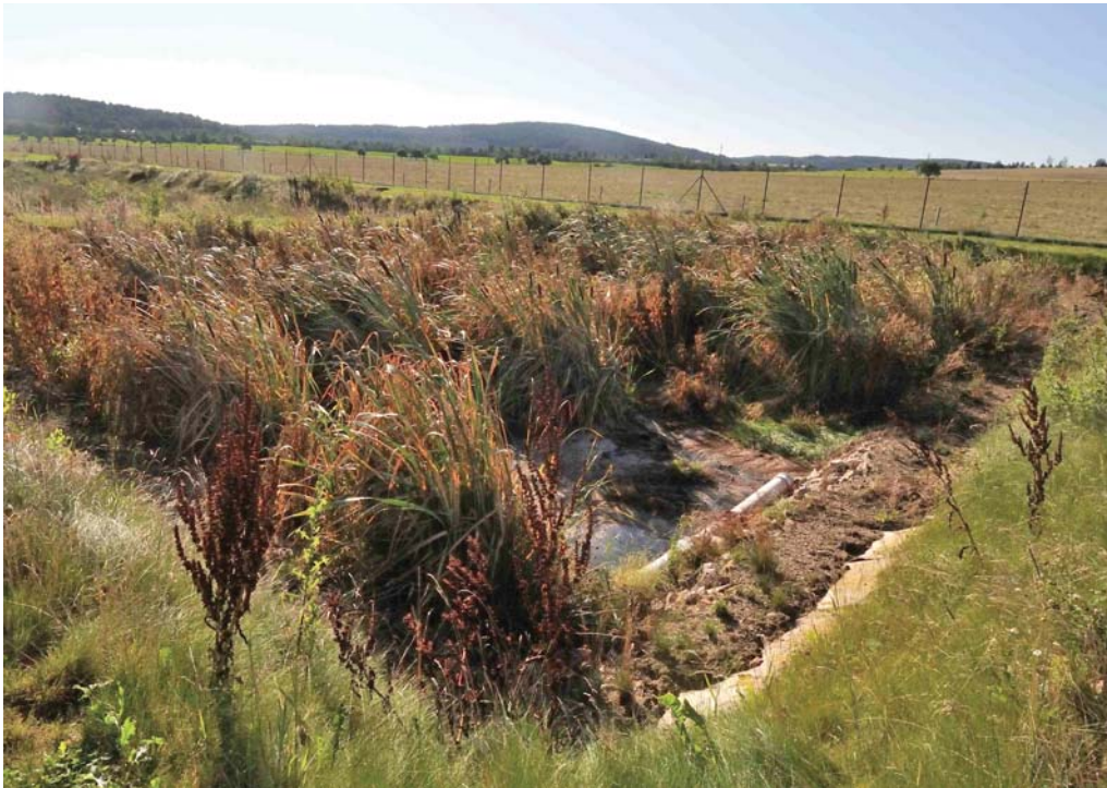
Kořenové pole vertikální kořenové ČOV zkolaudované v roce 2020. Foto Jan Foller
