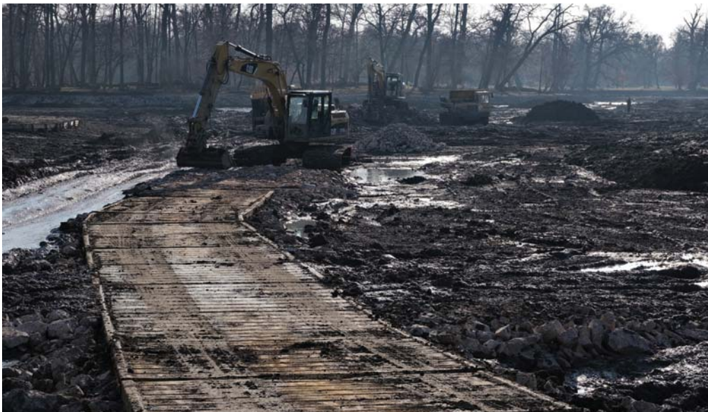
Ochrana a zpevnění břehů pomocí kovových panelů umožňující vjezd těžké techniky. Foto Oto Bernad
