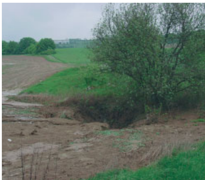
Eroze půdy do závrtu po přívalem dešti
