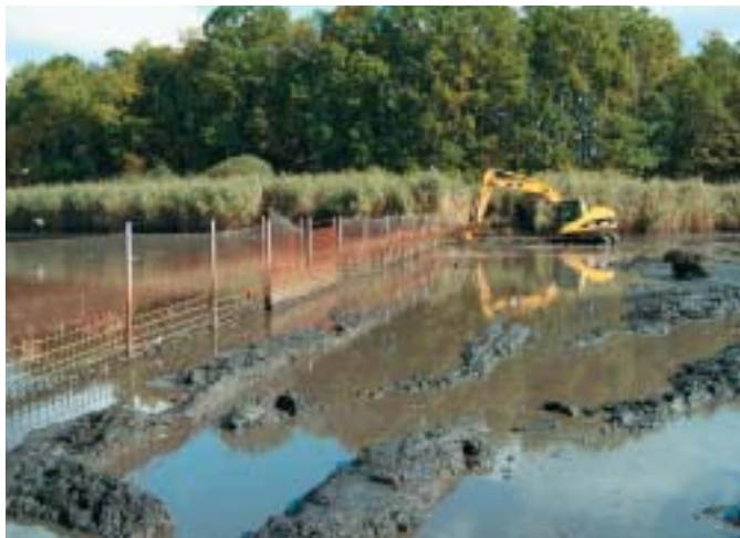
Odstraňování dělicího plotu mezi Přeseckou zátokou a hlavní plochou rybníka Velký Tisý po ukončení několikaletého experimentu. Na konstrukci jsou patrné známky silné koroze probíhající v agresivní rybníční vodě (pletivo vydrželo s obtížemi dva roky a muselo se při výlovu opakovaně opravovat) Foto B. Kloubec
