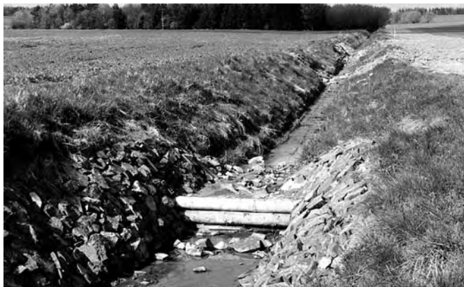
Oprava upraveného koryta, kterou nelze pokládat za hodnotnou revitalizaci. Zásah nevyřešil nevyhovující směrové vedení koryta ani neodstranil nevyhovující opevnění tvárnici. Velmi skromný příspěvek dřevěných prahů, obložených dlažbou, k podélnému rozčlenění koryta není přiměřený velkým pořizovacím nákladům
