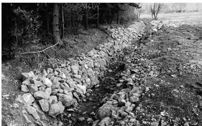
Zbytečně mohutné opevnění revitalizovaného koryta kamenem. Technicky nepodložená snaha důsledně nahradit původní tvárnici opevnění kamenným záhozem nebo rovnáninou vede k plýtvání prostředky a ke vzniku malého vodohospodářského monstra. Těžké kamenné opevnění se snad z přírodovědeckého hlediska uplatní jako obdoba objektu zvaného „kamenná zídka pro plazy“
